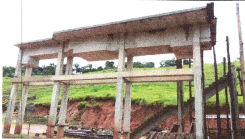
Foto 04: Estação de Tratamento de Esgoto - Tratamento Preliminar.
